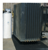
Ideaal onder lekkende transformatoren.
